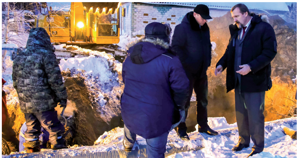
На месте порыва сетей водоснабжения по улице Полевой.
