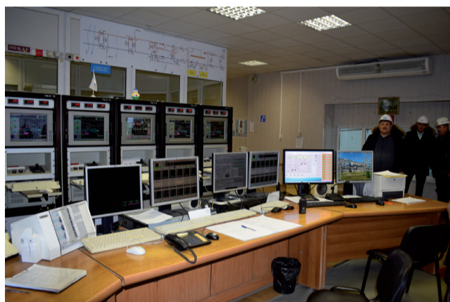
У главного щита управления.
